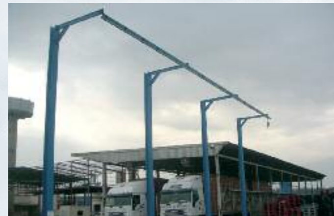
Línea de Raíl galvanizado para subida a camiones
