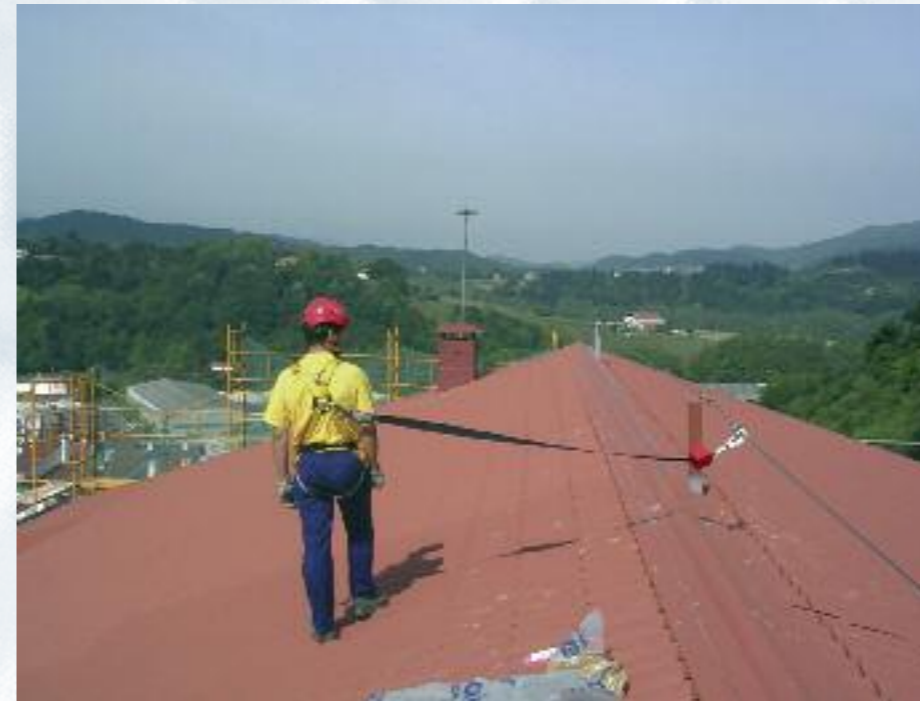
Línea horizontal cable en tejado
