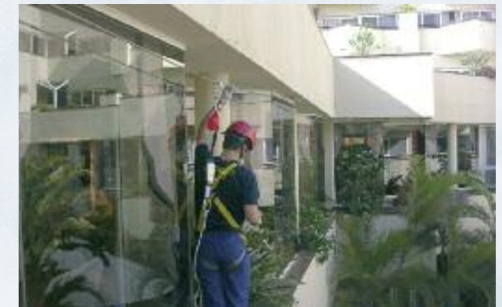
Línea horizontal cable lifeline en jardineras
